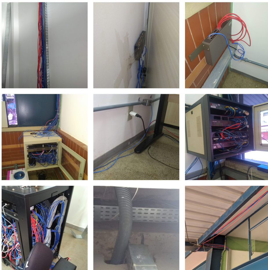
Figura 2: Imagem - Rede de Dados Instalação Incorreta
